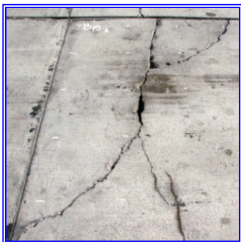
Fig. 2 a Dală B fisura colțului [1 – S15]
