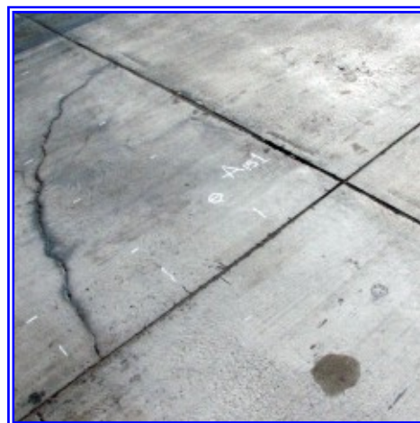
Fig. 1 b Dală A fisura colțului [15 – S1]
