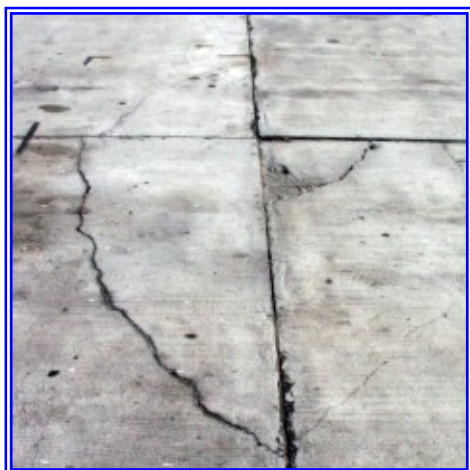
Fig. 1 a Dala A fisura colțului [15 – S15]
