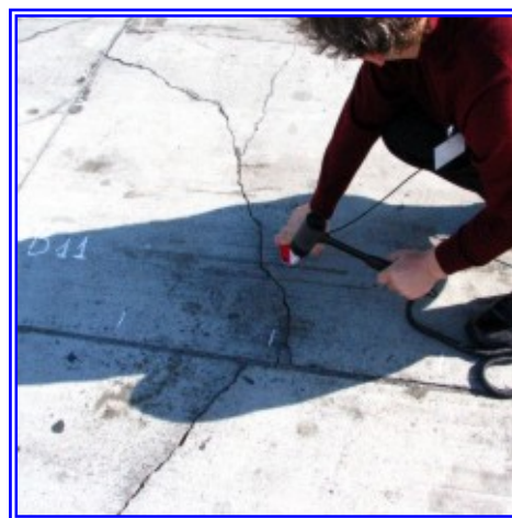
Fig. 2 b Dală B fisura colțului [1 – S1]
